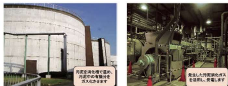
汚泥消化ガス発電（消化槽・発電機）
