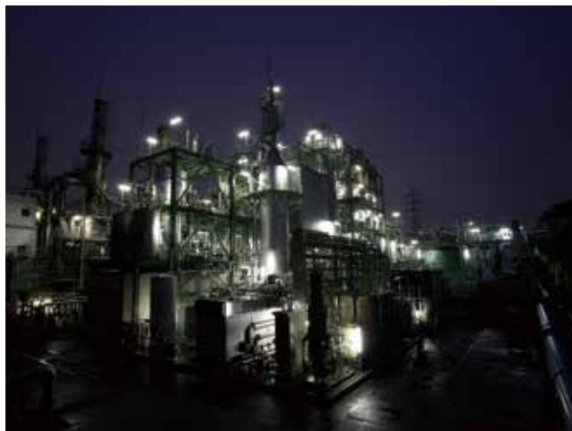
清瀬水再生センター 汚泥ガス化炉
