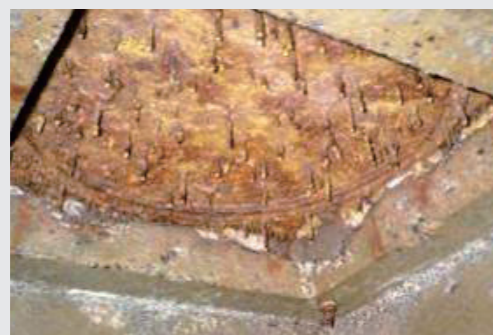
腐食したビルピットの蓋（裏面）
