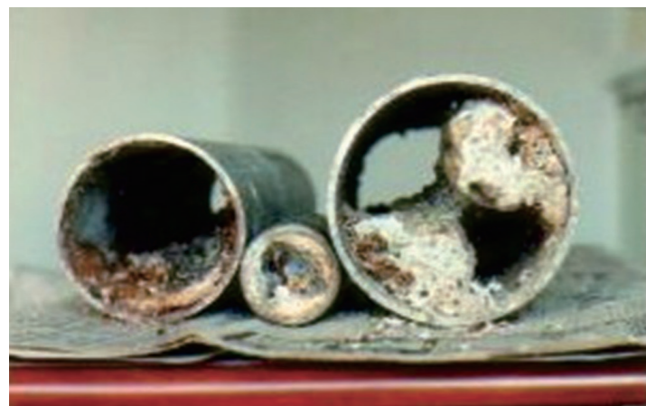
<被油脂堵住的室内排水管>
