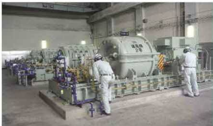
送風機の点検(北多摩一号水再生センター)
