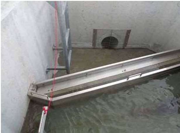
実習施設装置部分
