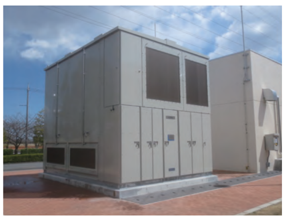
NaS電池 (浅川水再生センター)
