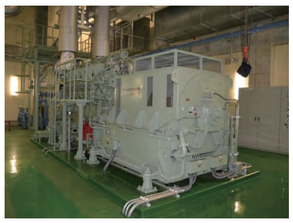
非常用発電機 (北多摩一号水再生センター)
