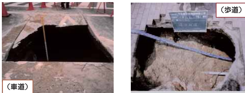
写真2-2 道路陥没の発生状況
