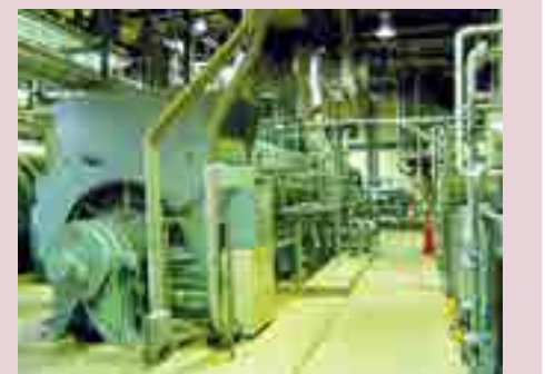
▲ガスエンジン発電機
