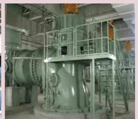
▲神谷ポンプ所雨水ポンプ設備
