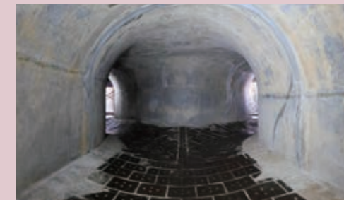
▲ 泵井连接暗渠
