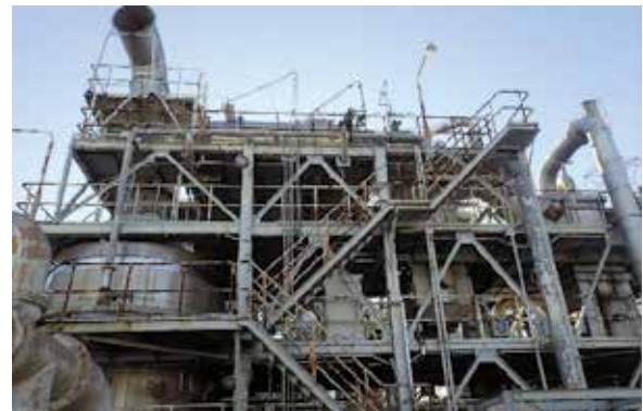
図4 北野下水処理場の老朽化した施設
