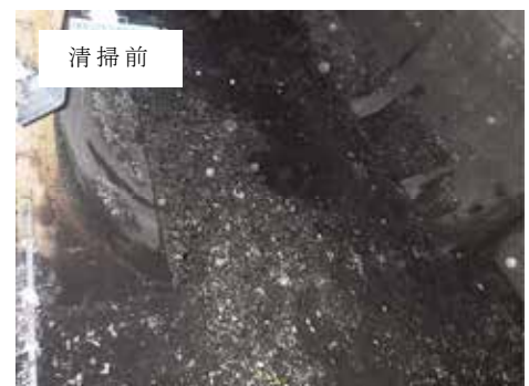
図 2 ふかし上げ人孔内の堆積状況
