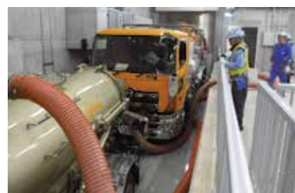
図 6 人孔建屋内での配置状況
