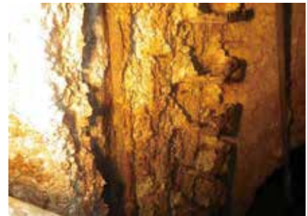
図3 角落し設置溝の腐食状況
