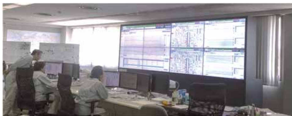
図3 再構築後監視室（八王子水再生センター）
