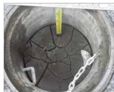
写真1 人孔内における土砂の固結状況
