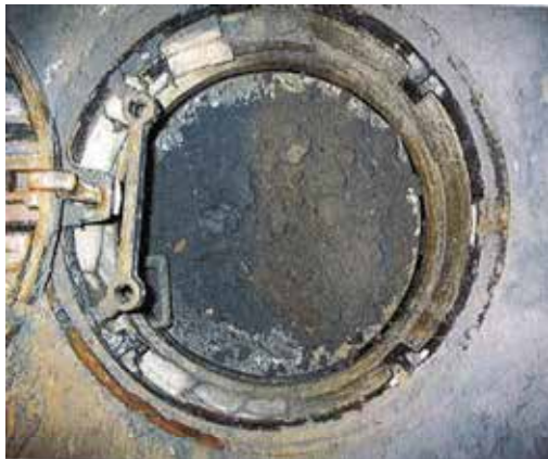
図3 □ 人孔の堆積土砂
