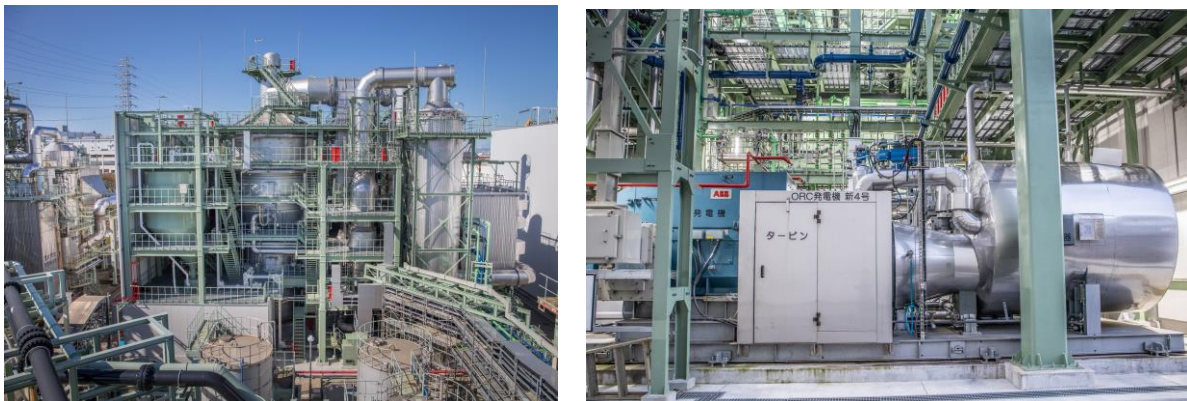
図 2-22 エネルギー自立型焼却炉（新河岸水再生センター）
