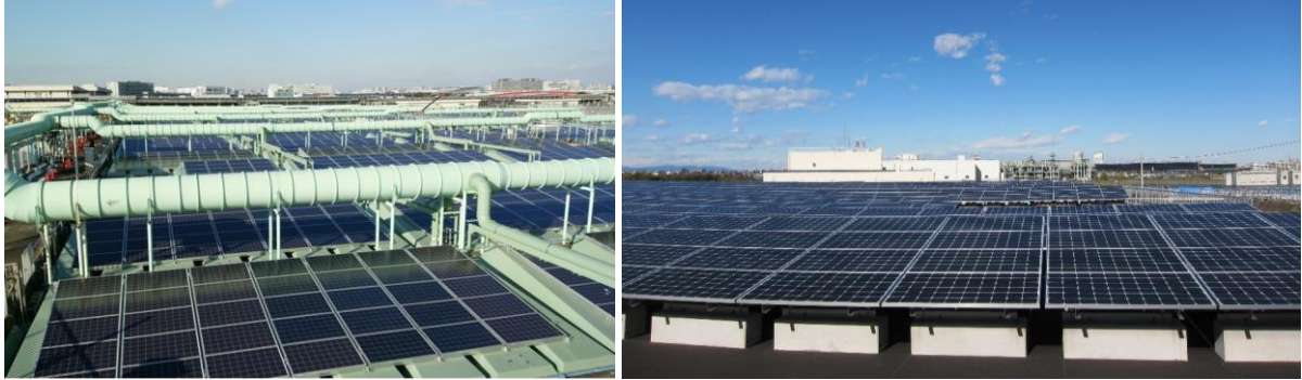
施設上部の設置例(森ヶ崎水再生センター反応槽上部) 下水処理施設の再構築用地などの設置例(南多摩水再生センター)
