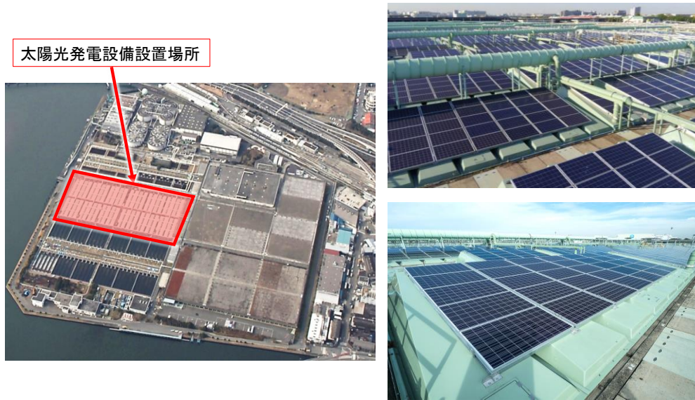
図 2-17 太陽光発電設備（森ヶ崎水再生センター）
