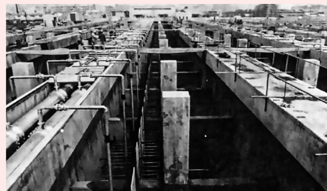
深槽反応槽 (1975年-)
