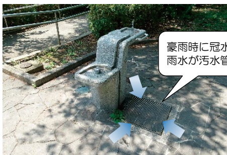
屋外流し等から污水管への直接浸入
