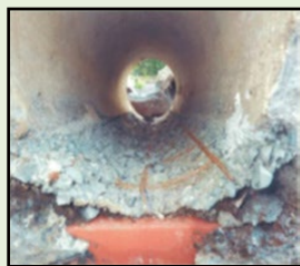
損傷した下水道管
