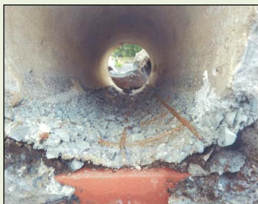
損傷した下水道管
