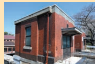
② 入口阻水门室临时屋顶 东、西各有1房，地下有维修时暂时阻止下水道水流的门。
